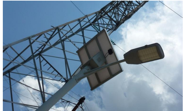
Photo 2. Pylône et éclairage solaire à Bolivar (WE/SPORA 2013)
